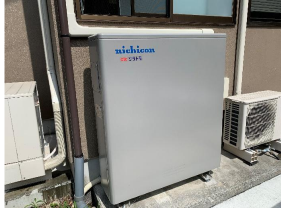
（太陽光発電と連携した蓄電設備）
