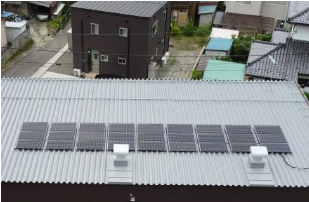
（倉庫屋根・太陽光発電設備）
