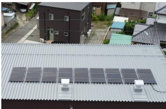
(倉庫屋根・太陽光発電設備)
