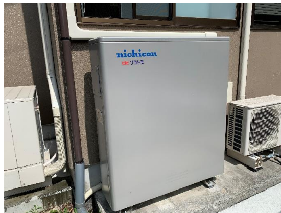
(太陽光発電と連携した蓄電設備)
